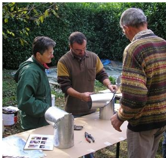
Construction du coude sans soudure, situé au cœur du fourneau à bois
